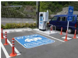
道の駅の充電設備
